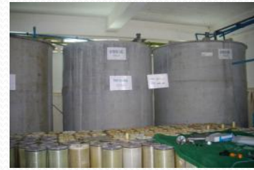
DI & RO Storage Tank for
